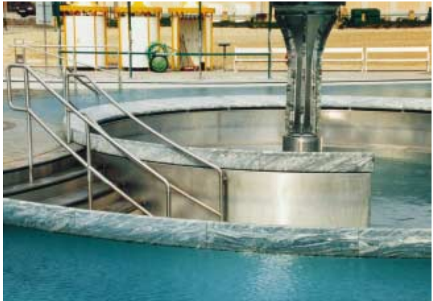
Eleganz schon vor der Flutung: Das kreisrunde Whirlpool-Becken aus Edelstahl Rostfrei, erhöht in das Nichtschwimmerbecken eingebaut, und das geschwungene Einstiegsgeländer zeigen die unterschiedlichen Oberflächenwirkungen des Werkstoffs.
