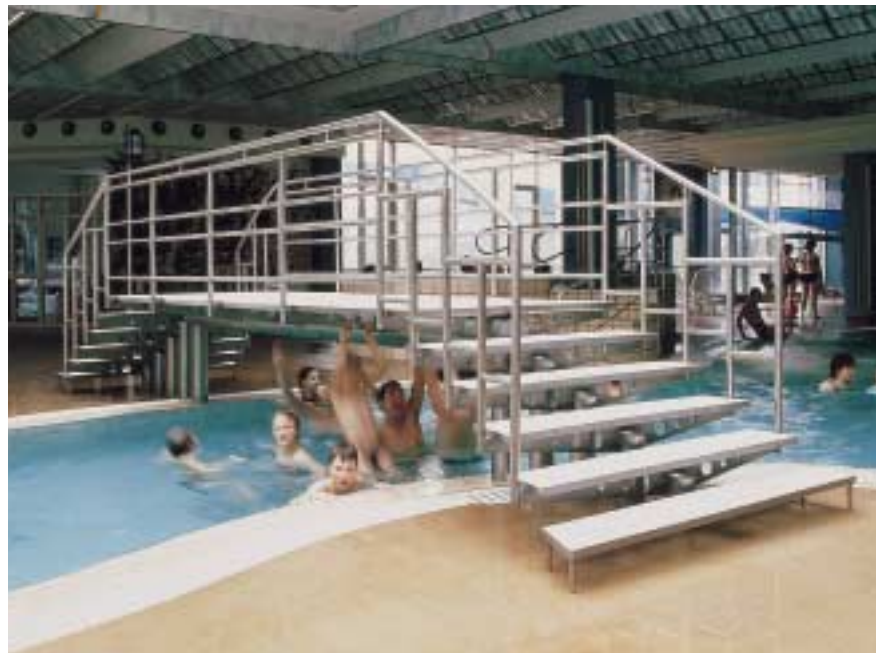
Diese Brücke komplett aus Edelstahl Rostfrei ist ein gutes Beispiel für eine empfehlenswerte Konstruktion im Spritzwasserbereich.
